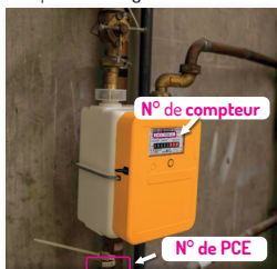
Compteur sans régulateur (détendeur)
